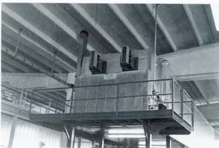
Fig. 10 - L'esterno del forno: si noti il gruppo di scambio termico
