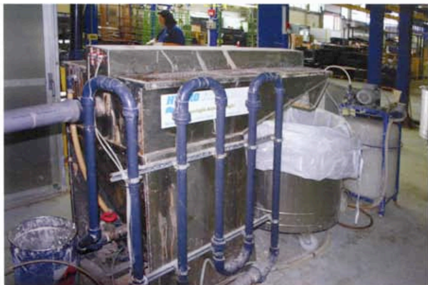
6 - Il trattamento delle acque di cabina.
